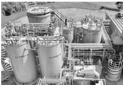
排水処理施設
