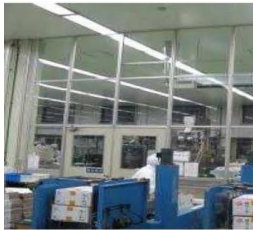
空気を経由した汚染の防止設備 (パーティション) の導入
